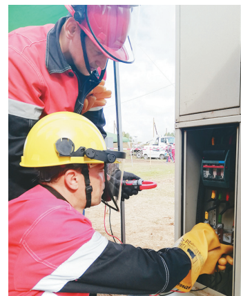
Определение повреждения на кабельной линии 0,4 кВ
