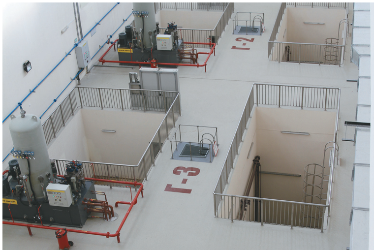
Машинный зал ГЭС
