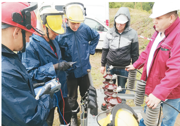
Определение повреждения трансформатора
