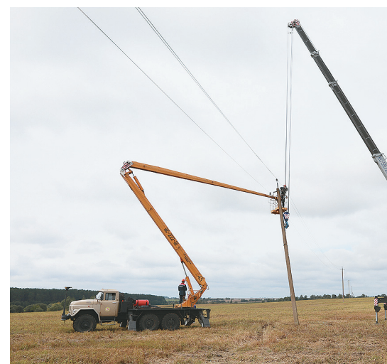
Замена опоры ЛЭП, поврежденной комбайном как по сценарию, так и в реальности
