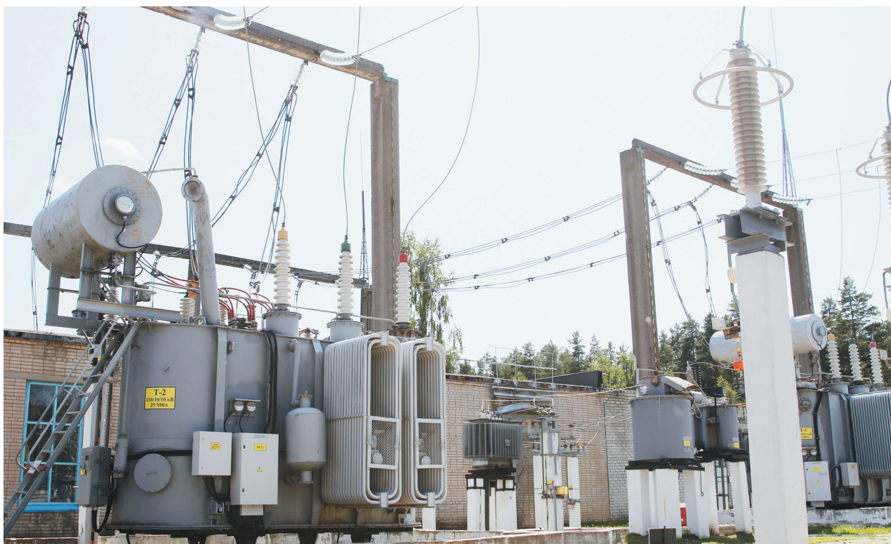
Недавно реконструированная ПС 110/10 кВ «Новополоцкая» — основной центр питания крупного города
