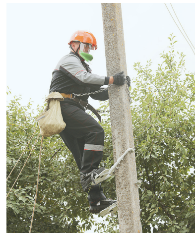
По легенде, в населенном пункте Еремеевщина повредился провод на вводе в жилой дом
