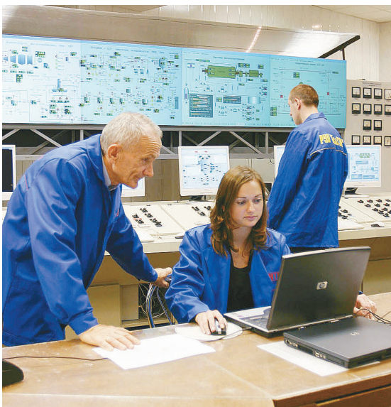
Наладка АСУ ТП энергоблока 250 МВт Минской ТЭЦ-4
