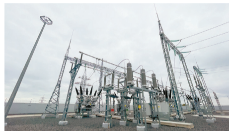
ПС 110 кВ «Дуброва»
