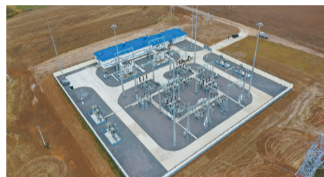
ПС 110 кВ «Аульс»
