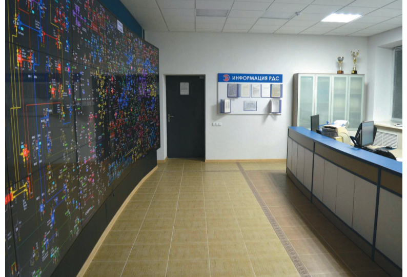
Современный диспетчерский зал Быховского РЭС
