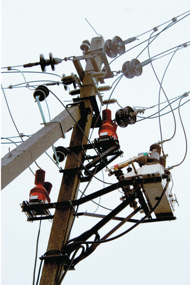
Смонтированный вакуумный реклоузер на ВЛ-10 кВ
